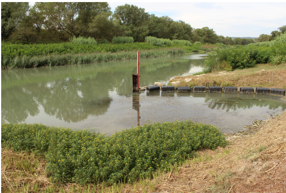
Figure 6. Vue de la vanne de L'Aygues - (ACME - 2024)
