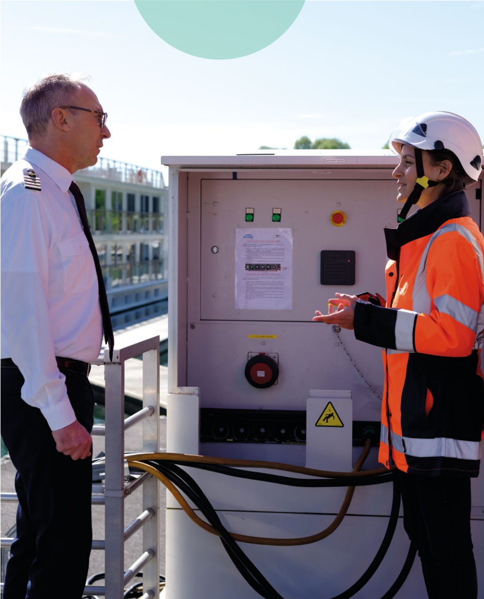
↑ Borne haute tension pour l'alimentation des bateaux à passagers à Tournon-sur-Rhône
