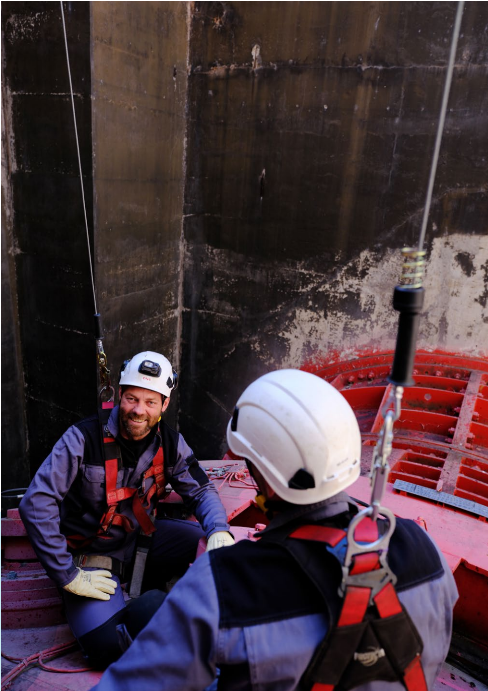
Innov'Action sécurité → (système de poutre d'assujétissement et filin de sécurité)
