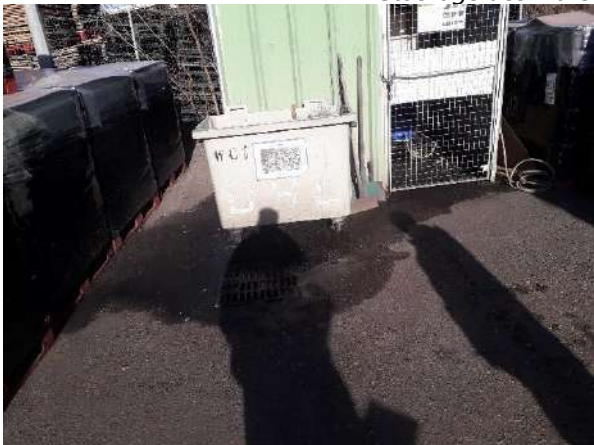
Zone de lavage avec débourbeur/SH
