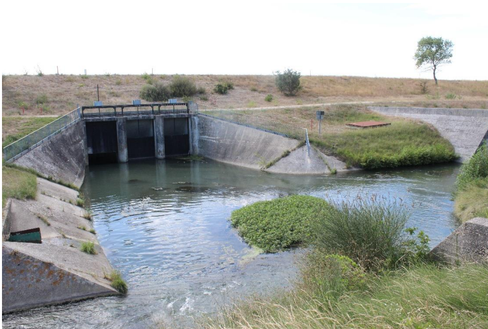
Figure 13. Accumulation de sables dans le bassin amont du siphon de la Gaffière (ACME – 2020)
