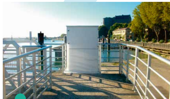
Bornes haute puissance sur les appontements pour bateau à passagers de Tournon-sur-Rhône
