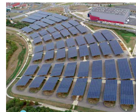
Parc d'ombrières photovoltaïques de l'espace Carat vers Angoulême (Charente) de Reden Solar agrégé par CNR.
