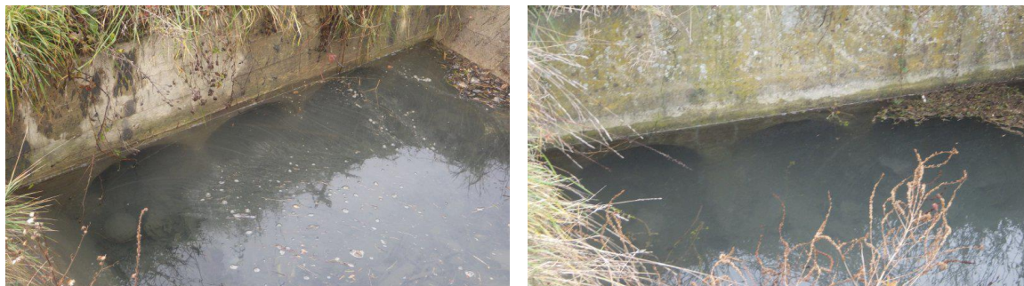
Figure 5. Vue de la tête amont (photo de gauche) et de la tête aval (photo de droite) de l'aqueduc de réalimentation - (SATIF -2020)
