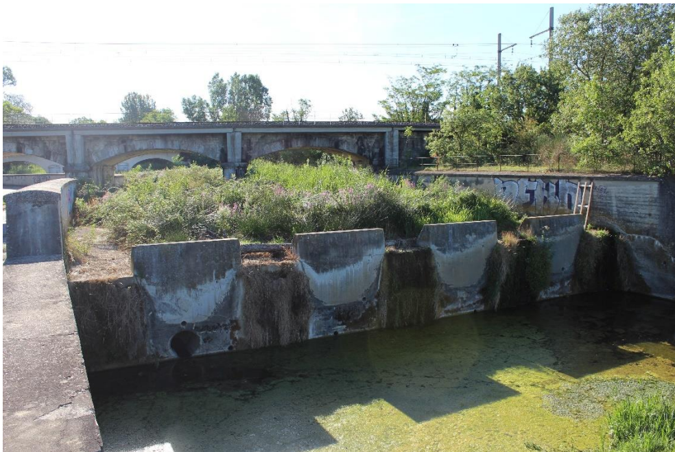
Figure 6. Vue du seuil en aval du piège à graviers de la Riaille amont (ACME 2016)
