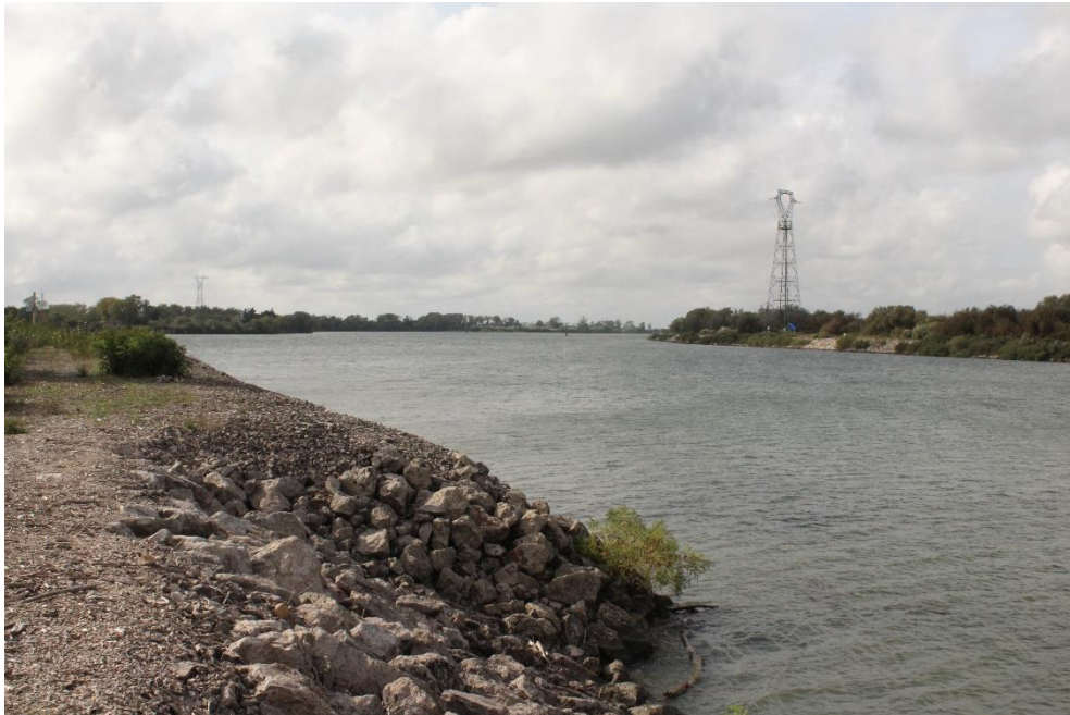
Figure 8. Vue des berges en enrochement vers l'amont de l'embouquement de Barcarin (ACME 2021)
