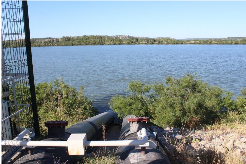
Figure 6. Vue de la tête amont de la prise d'eau des Arméniers - (ACME -2020)
