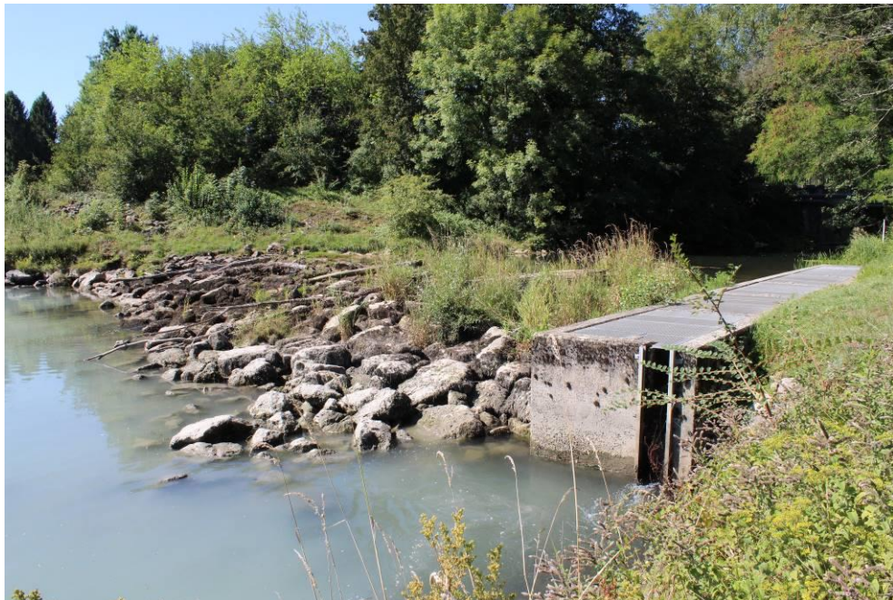
Figure 2. Aménagement piscicole du seuil du Furans avec ses caillebotis – CNR 2017
