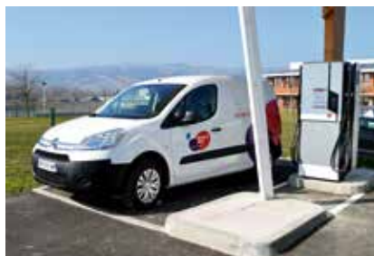
Station de recharge électrique CNR à Bourg-lès-Valence
