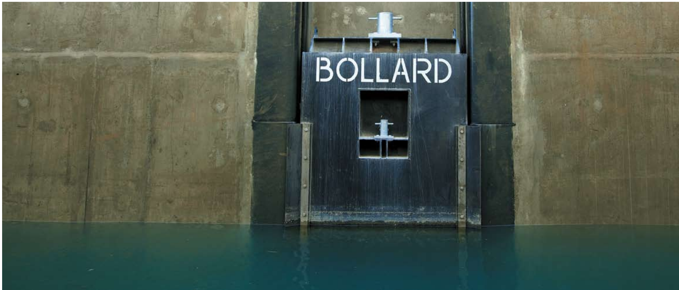
Ecluse de Belley, système d'amarrage flottant
