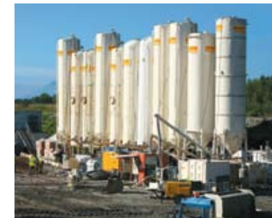
Centrale à béton
